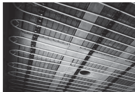
Rysunek 26 System railjet zamontowany na suficie - przeznaczenie ogrzewanie i chłodzenie sufitowe
