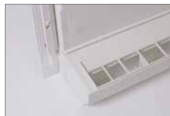
Regleringsspjäll för tilluft öppet
