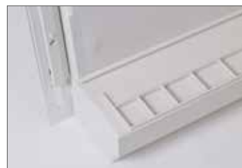
Regleringsspjäll för tilluft stängd
